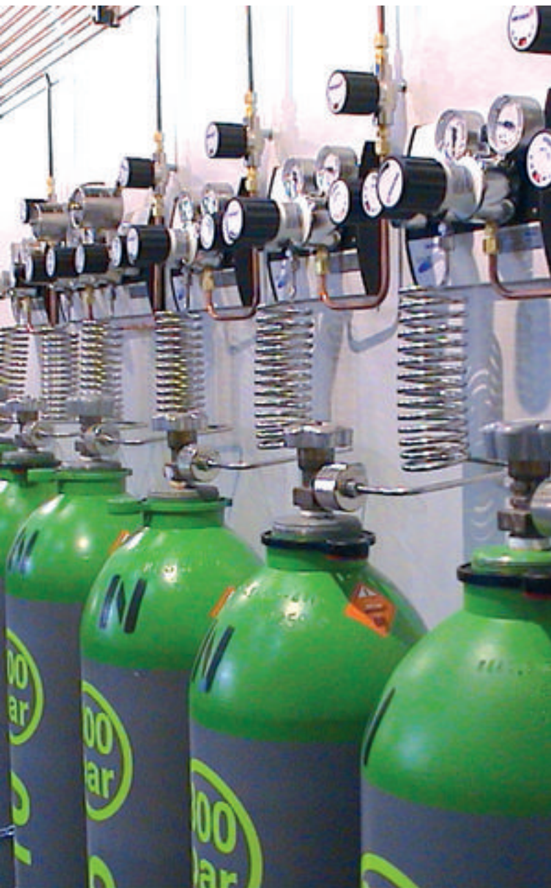
Central de suministro de gas
